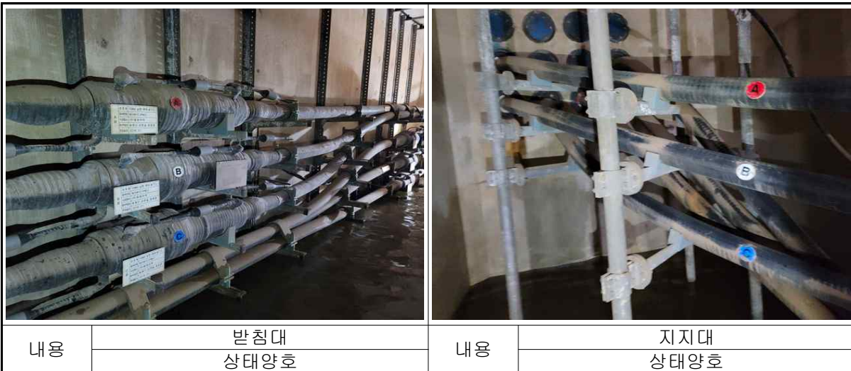
【사진 4.48】 부속 및 부대설비 현황
