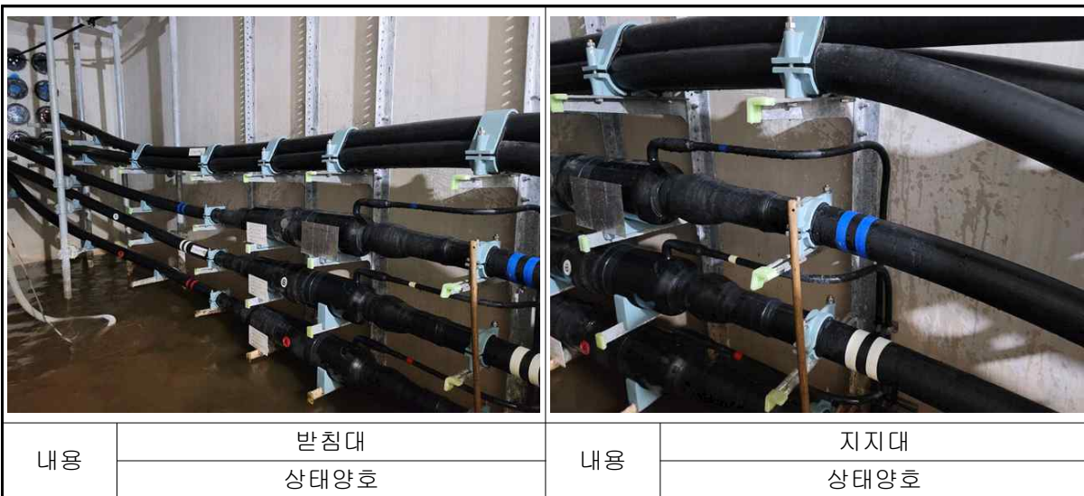
【사진 4.32】 부속 및 부대설비 현황
