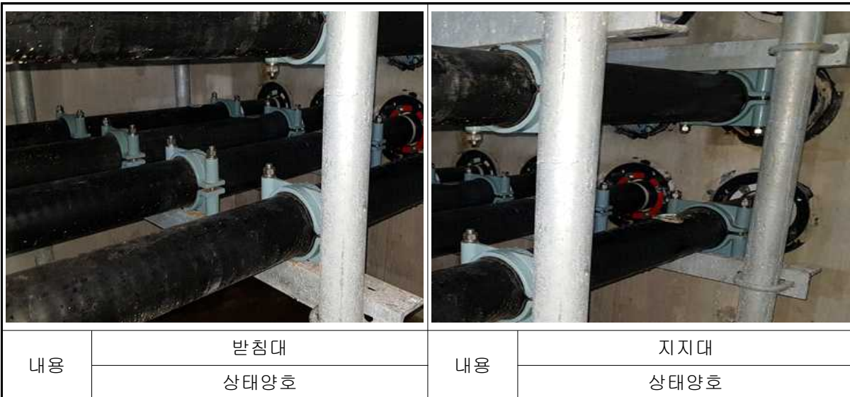
【사진 4.84】 부속 및 부대설비 현황
