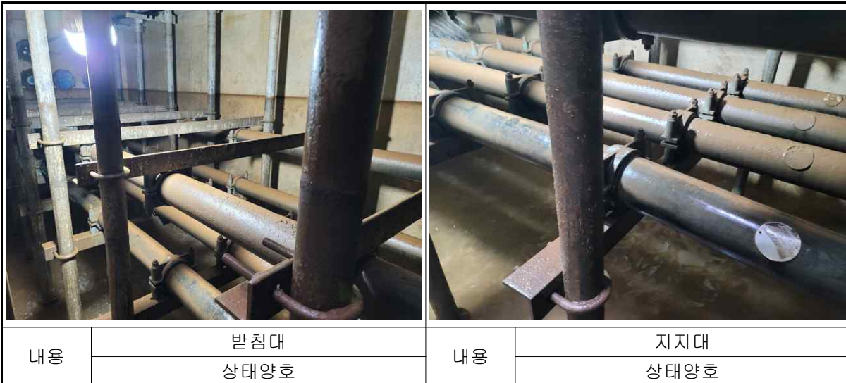
【사진 4.80】 부속 및 부대설비 현황
