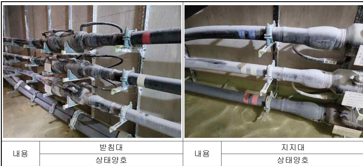
【사진 4.56】 부속 및 부대설비 현황
