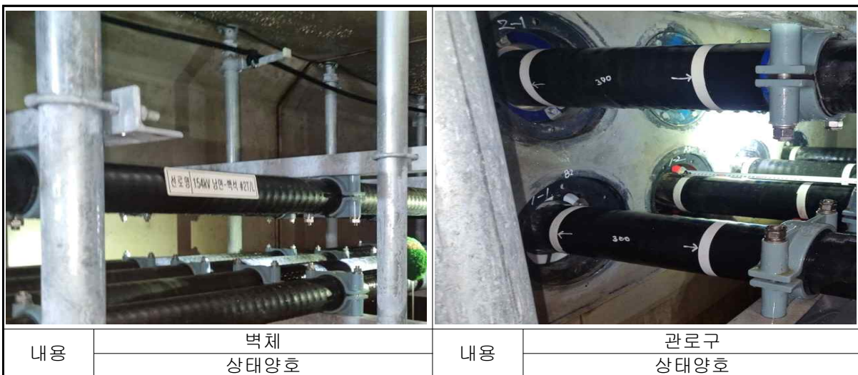
【사진 4.90】 맨홀 내부 주요 손상
