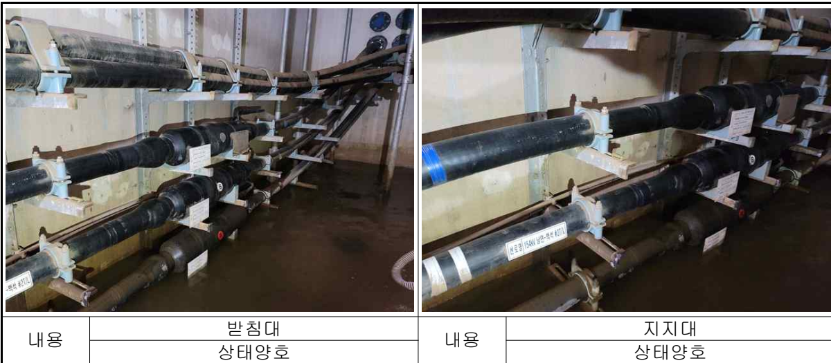
【사진 4.44】 부속 및 부대설비 현황
