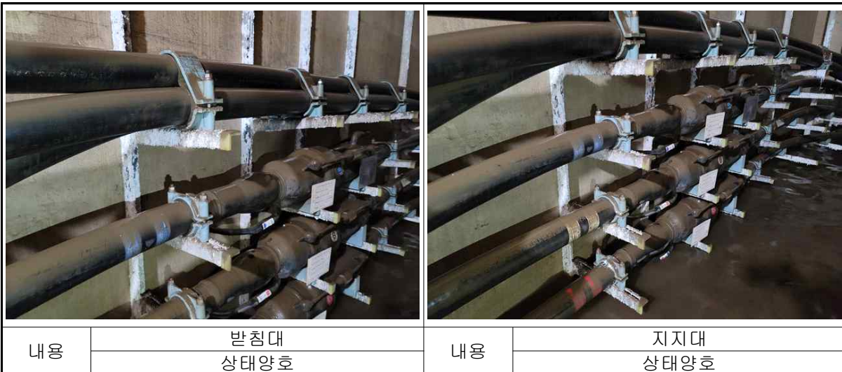
【사진 4.36】 부속 및 부대설비 현황
