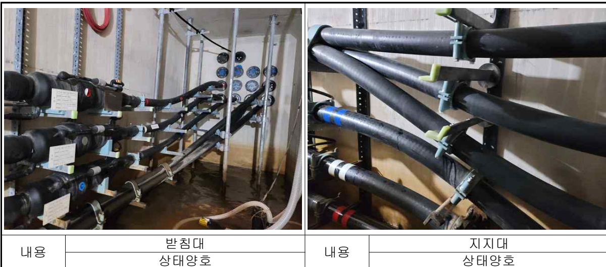
【사진 4.40】 부속 및 부대설비 현황
