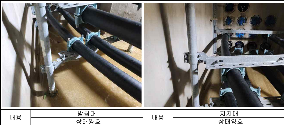
【사진 4.8】 부속 및 부대설비 현황
